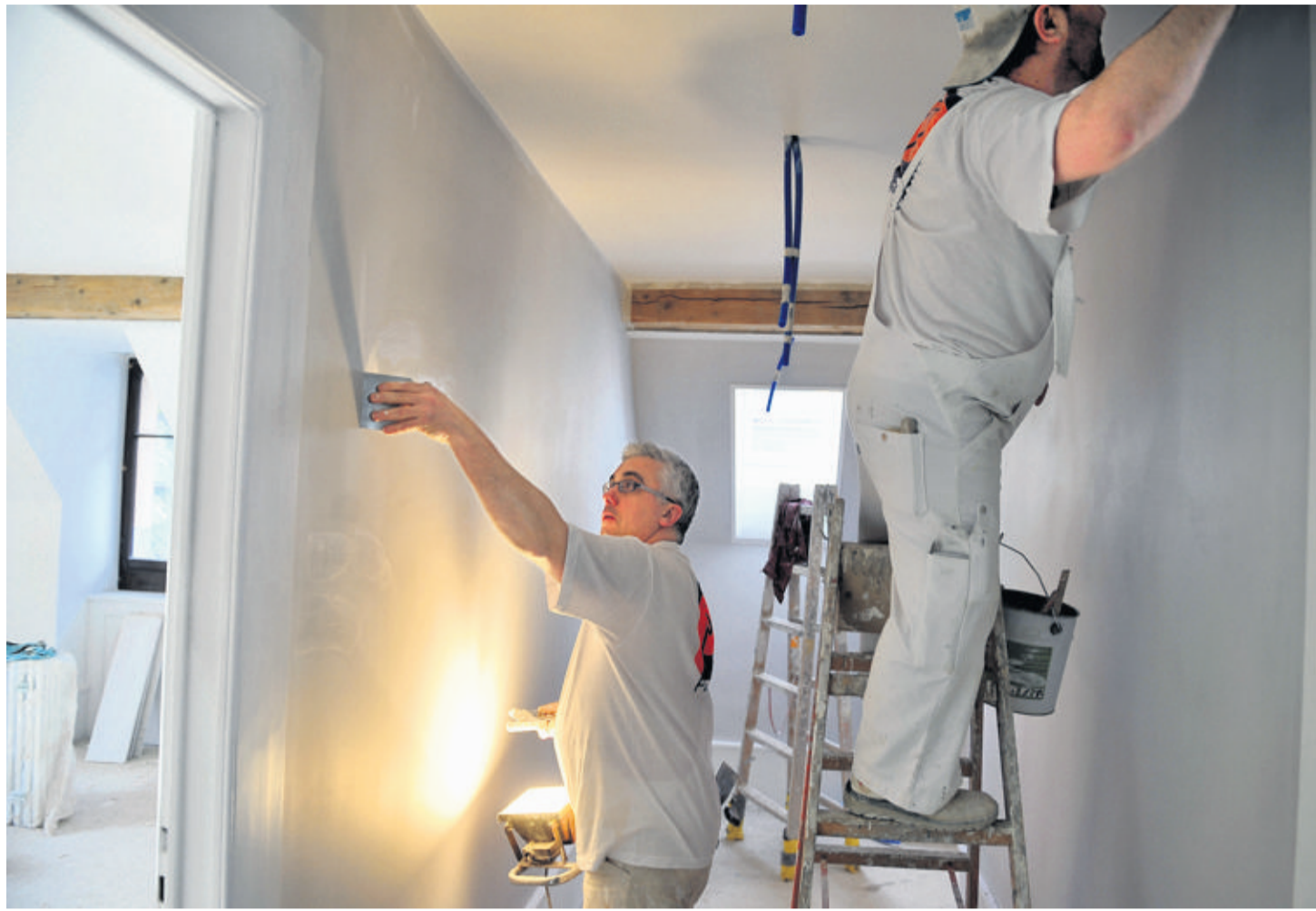
La gypserie-peinture est la branche du second œuvre la plus touchée par les problèmes de travail au noir et de dumping salarial. P. ABENSUR
